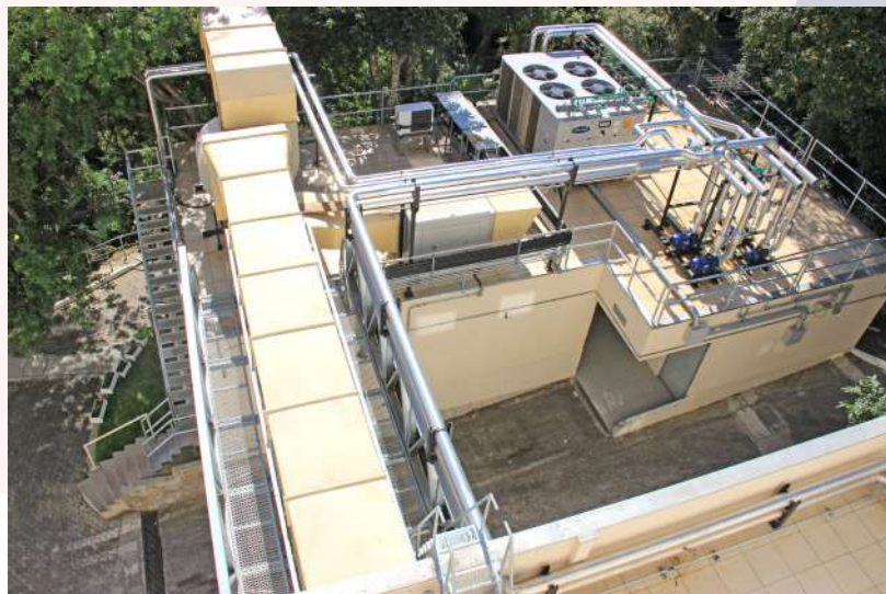
Foto 02: Subestação do Hospital Divina Providência, localizado em Porto Alegre/RS. Fonte: Acervo fotográfico da Formas & Efeito.
